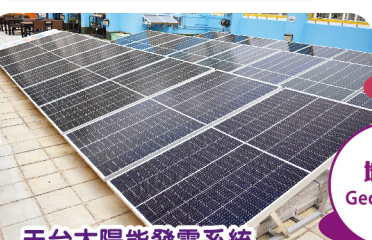
天台太陽能發電系統
