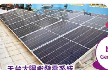
天台太陽能發電系統
