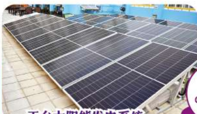
天台太阳能发电系统
